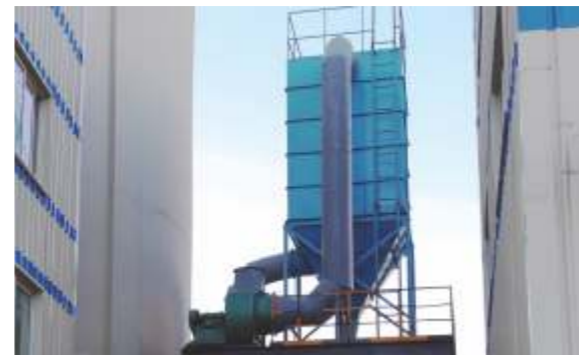
河北东梁公司除尘设备
