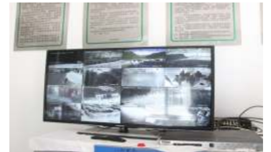
西藏华泰龙公司炸药库监控系统
